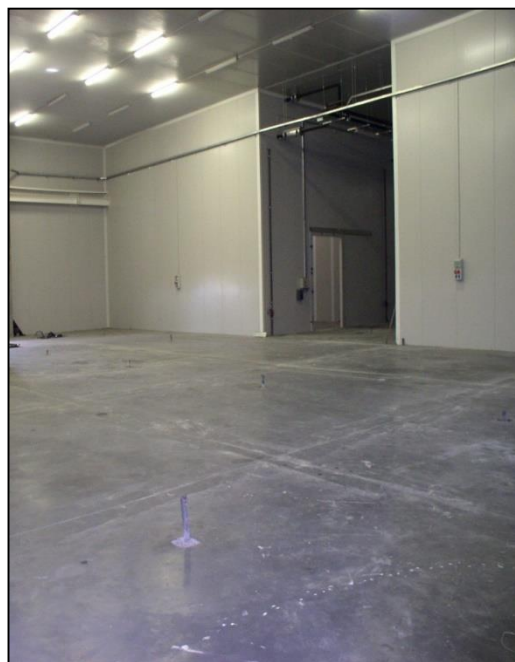
6. fénykép: Hűtőházi ipari padló - Bátortereny (forrás: Betonmix)
